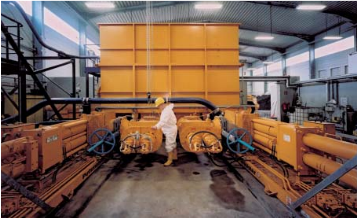
Annahmebehälter für Klärschlamm mit abfördernden Dickstoffpumpen
